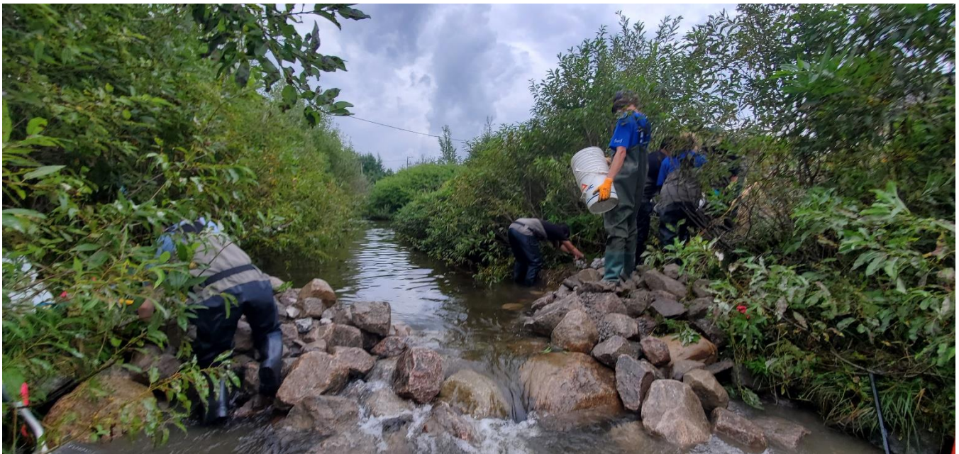
Figure 5 : Transport manuel du matériel et assemblage du seuil dans la rivière du Berger.
