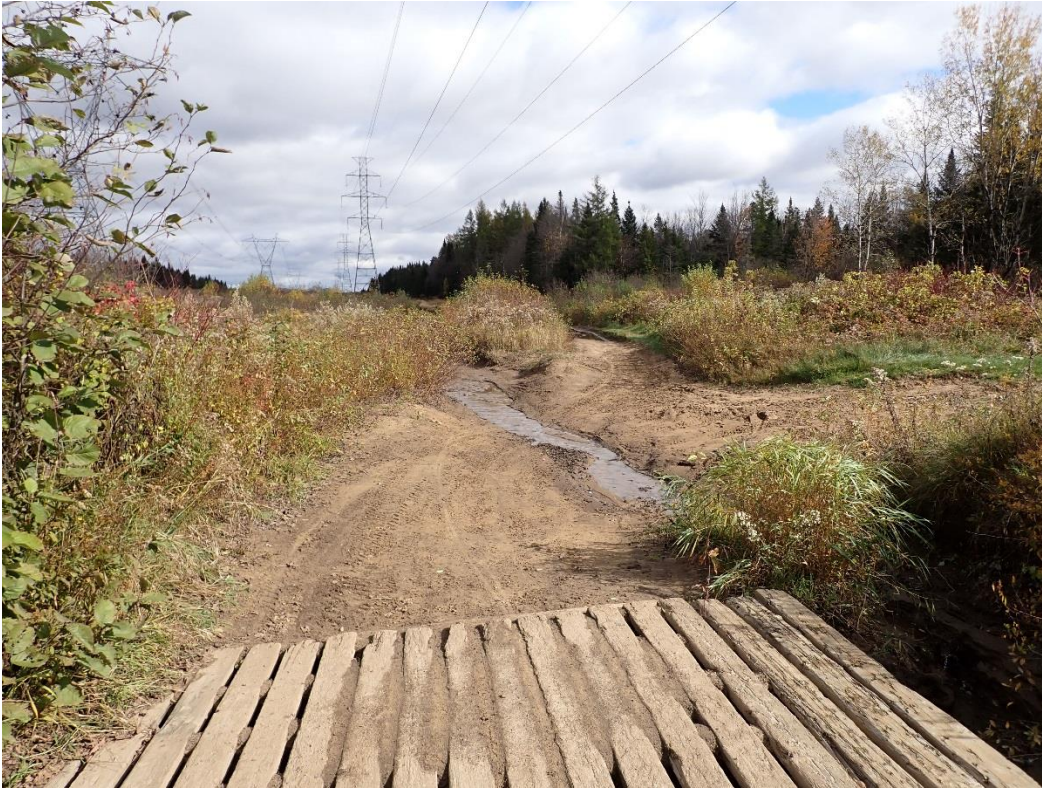
Figure 33 : Érosion dans le sentier de VHR (bassin versant de la rivière Nelson)
