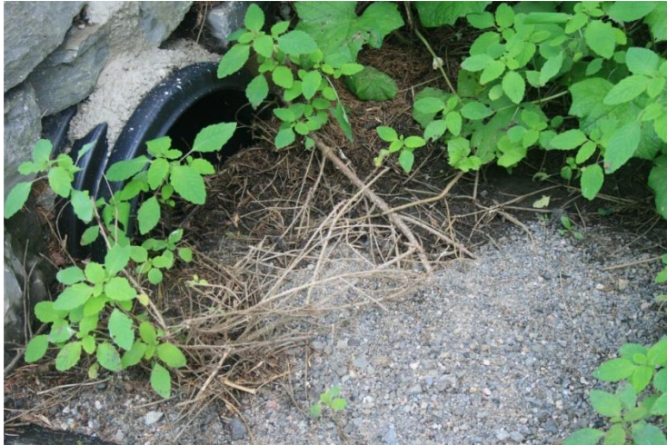
Figure 2.8.2: Comblement d'un fossé de drainage par les sédiments dans le bassin de la rivière Jaune
