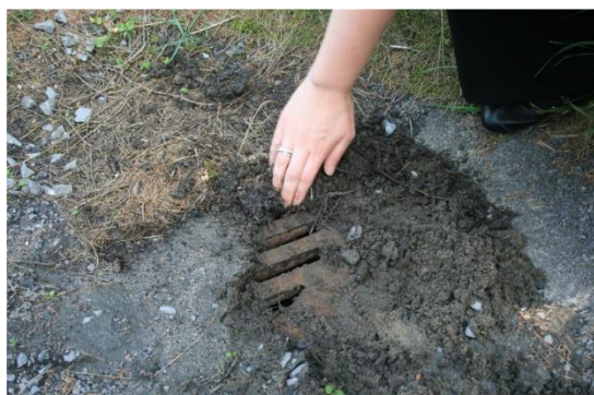
Figure 5.6.1.1: Accumulation de sédiments sur un regard d'égout pluvial, en aval d'un développement domiciliaire en forte pente. Photo: OBV de la Capitale, 2009.
